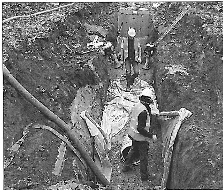
À Labry, la proximité de l'Orne nécessite que la pompe tourne à plein régime. Photos RL
