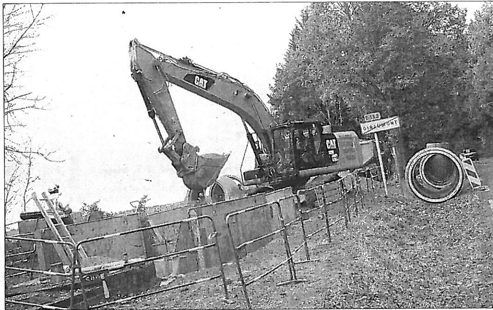
À Giraumont, le chemin piétonnier est interdit d'accès durant tout le chantier.
